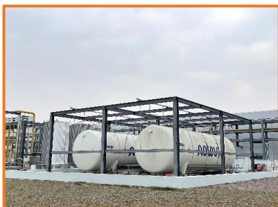
液化天然气储罐
